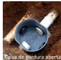
Caixa de gordura aberta
